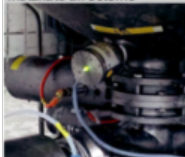
Vista del sensore installato all'esterno
