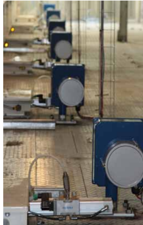
Misura di livello elettromeccanica
