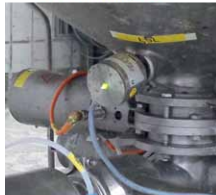
Sensore installato nel serbatoio dello yogurt
